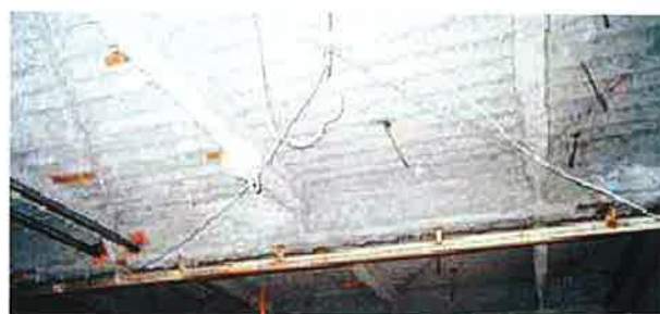
（建物天井への飛散性吹き付け石綿の状況）
